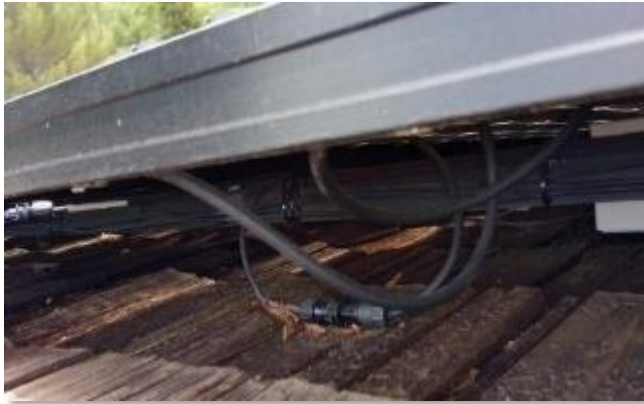
Conectores/cables colocados directamente sobre el tejado o en el suelo
